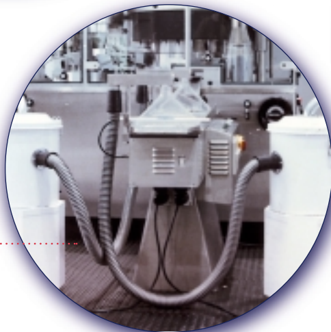
Succion ponctuelle sur un équipement de compression et succion de poussières dans l'industrie pharmaceutique.
